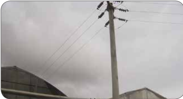
Şekil 15. Sera yakınında elektrik hattı
