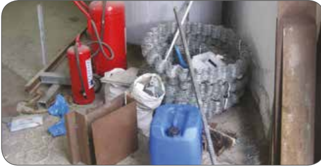
Şekil 14. Konum ve erişim yönünden uygun olmayan yangın söndürme ekipmanı
