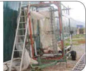
Şekil 9. Uygun olmayan el merdiveni kullanımı
