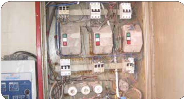
Şekil 16. Yetkisiz kişilerce erişilebilir durumda olan elektrik panosu
