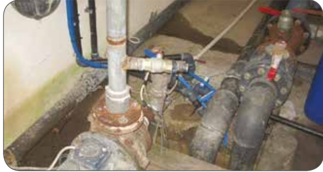
Şekil 17. Islak zemine temas eden elektrik kabloları
